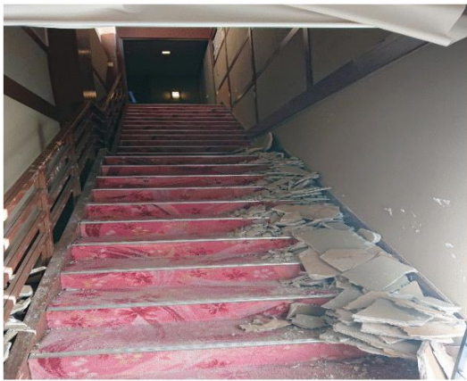
地震による施設被害
