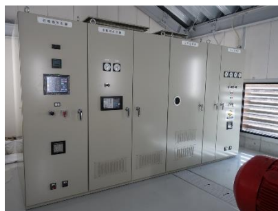
(発電機操作盤)
