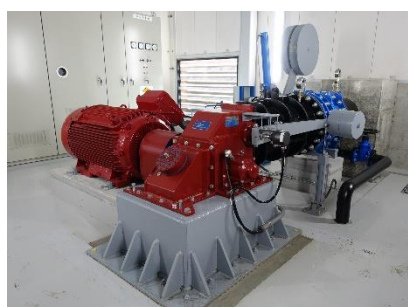
(水車・発電機)
