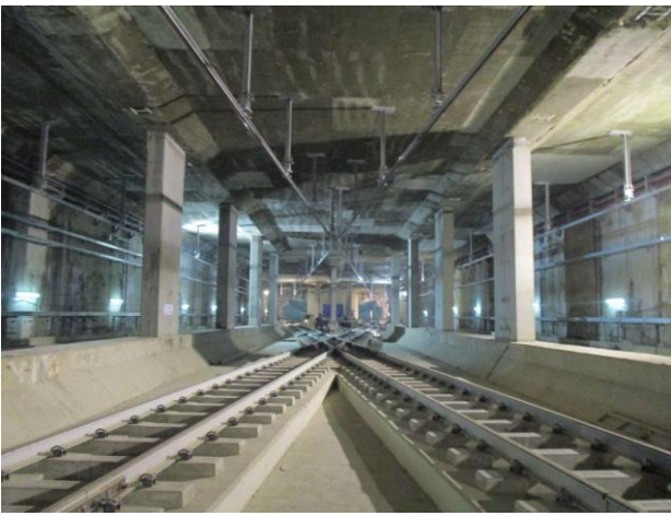
ブンデランハイ駅の南側に設置された地下軌道分岐（三井住友建設）
