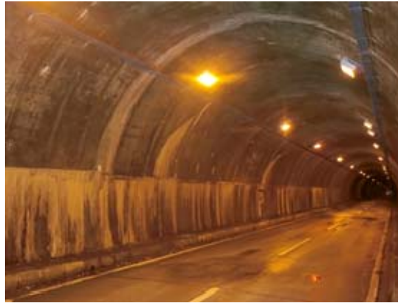
補修前の糠越隧道
